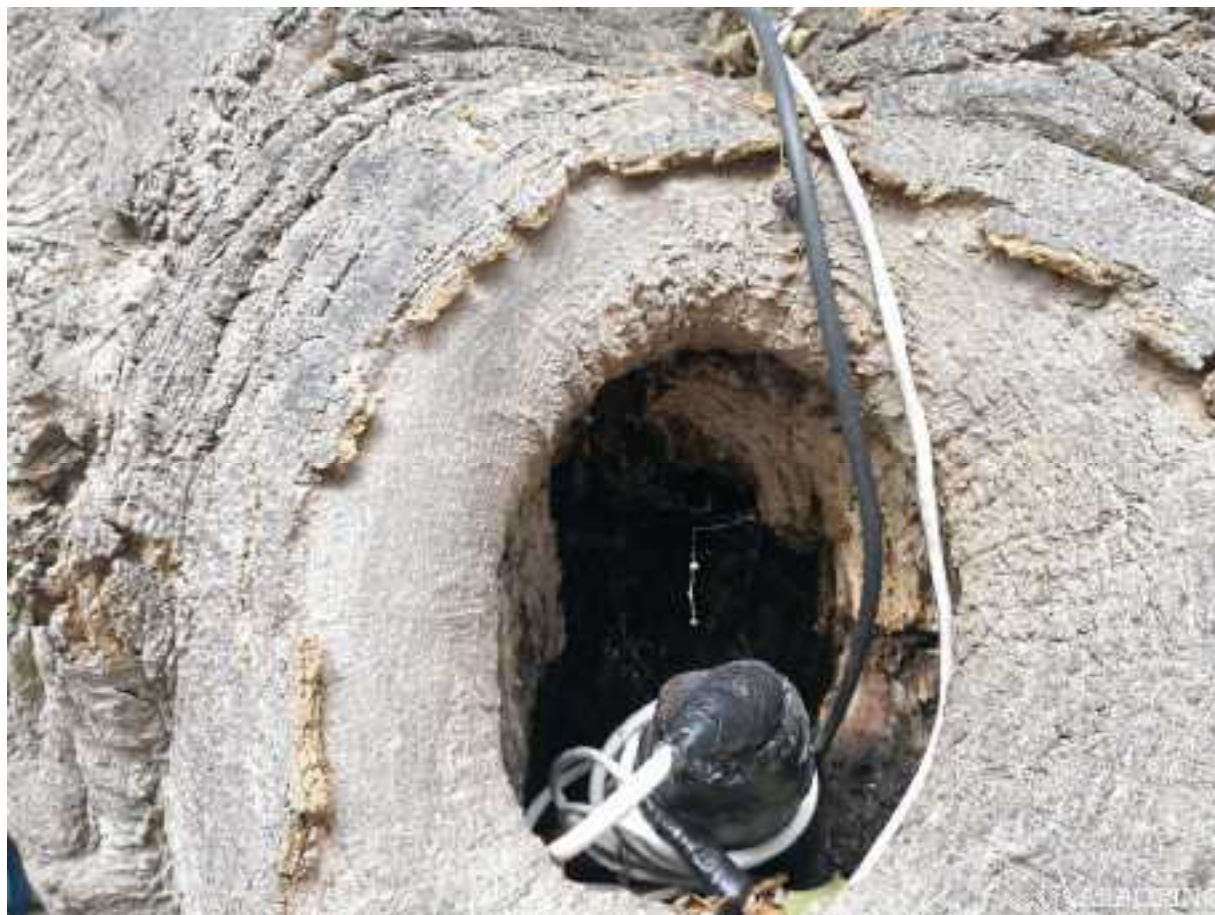
Slika 8 Elektroinstalacije u duplji na stablu 8.
